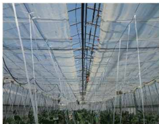
降雪前のビニールハウスの対策状況 （カーテンを開けて融雪を促している） 出典：雪害に対する農業用ハウス強化マニュアル （平成26年4月、群馬県）
