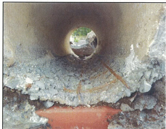
損傷した下水道管
